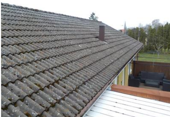
Svacka noterades i taket ovanför vardagsrummet.
