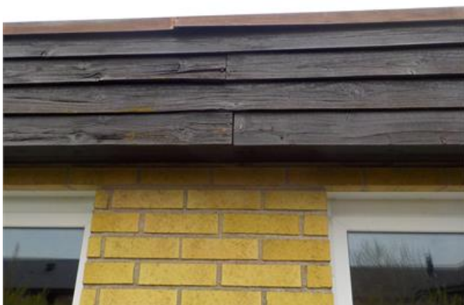
Torrspäckor och rötskador i taksargspanel.
