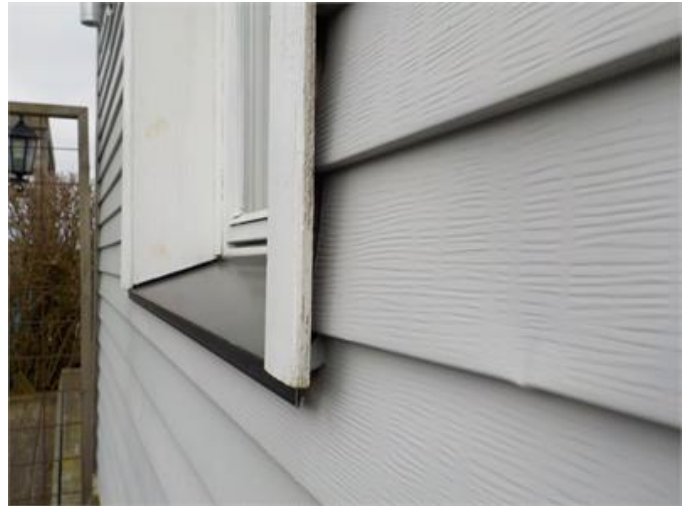
Otätt vid fönsterfoder/fasad vid södra gaveln.
