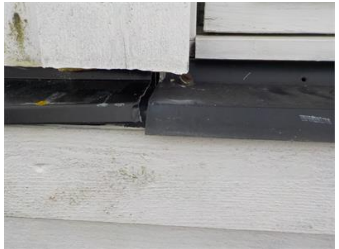
Bristfällig/otät skarv i fönsterbleck till kupan.
