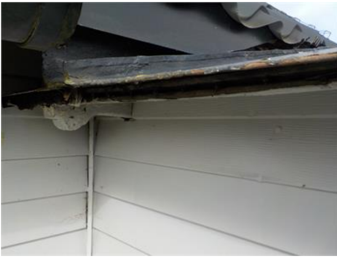
Brister i nederkant papp och rostangrepp i det falsade plåttaket.
