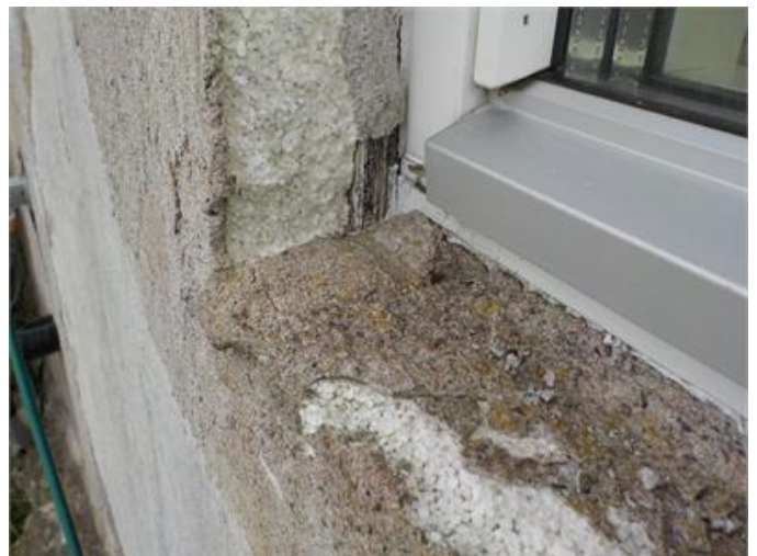
Brister i smyg och synligt trämaterial bakom cellplast vid köksfönster.
