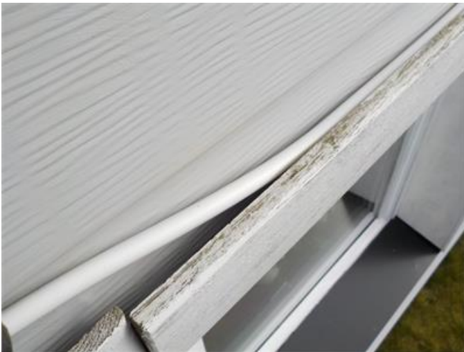
Öppet ner mellan foder och fasad vid södra gaveln.
