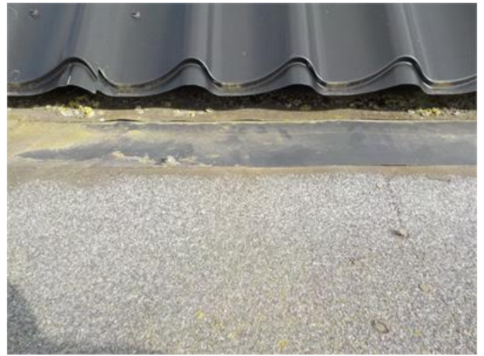
Spikar som har krupit upp från papptaket och papp som har lossnat från plåt.
