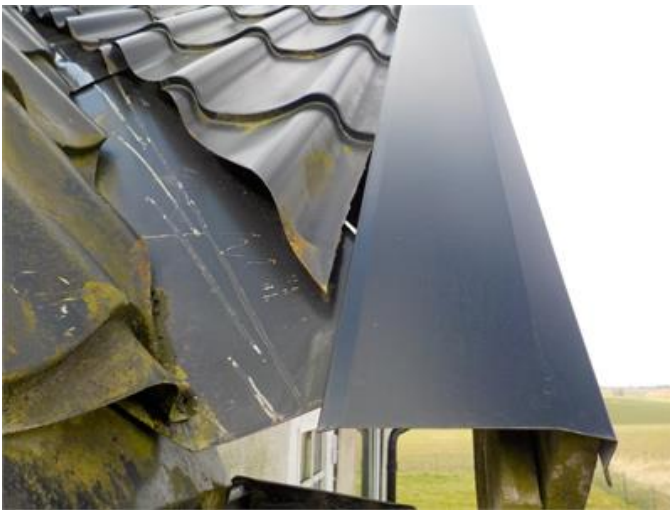
Rost i takplåt och öppet in mellan tak- och vindskiveplåt vid norra rännalen.
