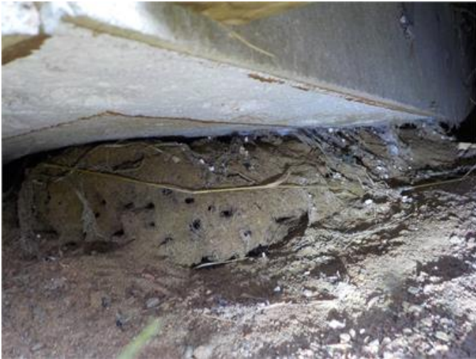
Grundelement vid kökshörnet saknar underliggande/bärande material.
