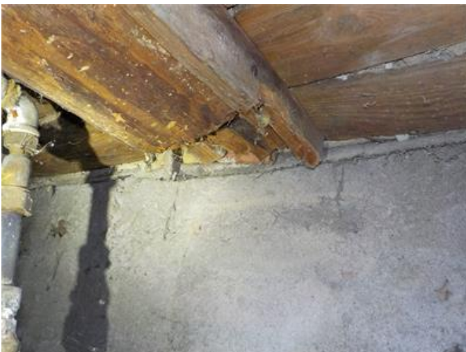
Rötskador i bjälklaget i anslutning till luckan.
